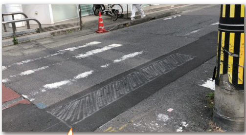
補修されず消えかかったままの横断歩道 (2023.5月布瀬撮影)
